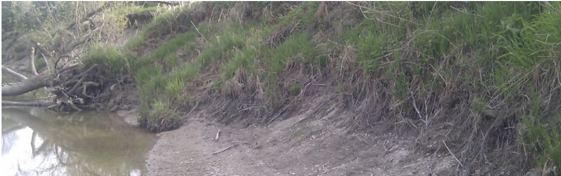
Abbildung 2: Uferentwicklung (feinkörniges Material unterlagert von Sand/Kies, ca. Do-km 2279,4)
