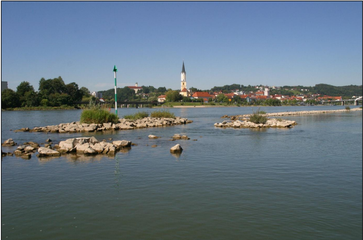
Abb. 6: Maßnahme I-0-21.4-V-FFH: Praxisbeispiel: fischökologisch optimiertes Leitwerk (Vilshofen, Bürgerfeld) mit wellenschlaggeschützten Öffnungen und vielfältigen Wechselbeziehungen zwischen Struktur und Strömung.
