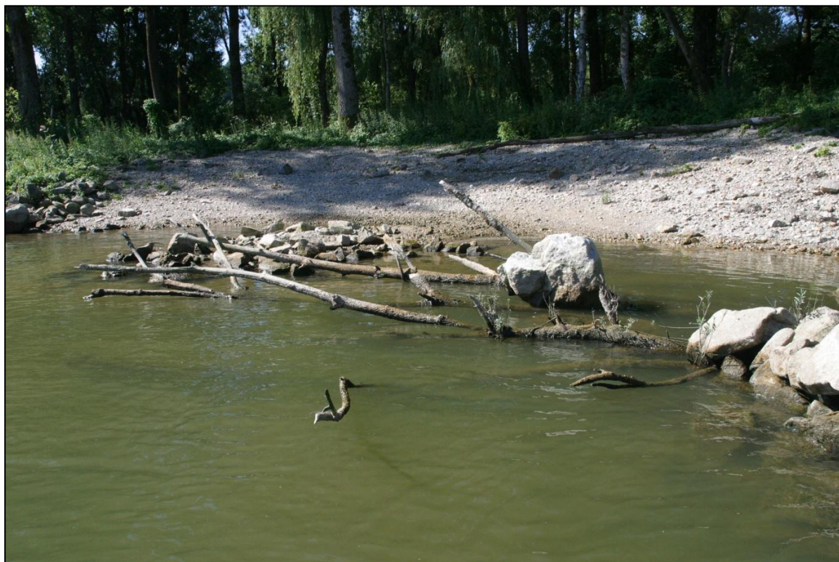
Abb. 12: Neu erstellter (2007) kleinräumiger Uferrückbau mit Hakenbuhne, Totholz-Blocksteinelementen und flach geneigter Uferböschung (Jungfischhabitate, Rückzugsbereiche bei Hochwasser); Donau Bereich Vilshofen, Bürgerfeld.
